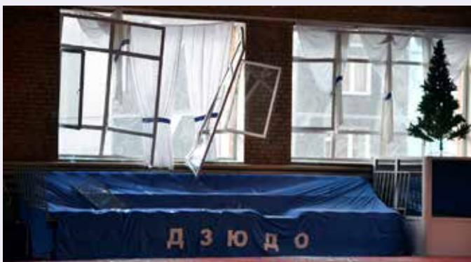
Fenêtres endommagées dans l'un des bâtiments de Tcheliabinsk. La toile dit « judo ».
